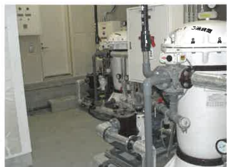
ろ過機械室風景
