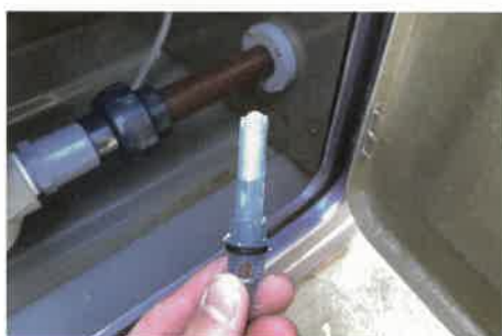
注入点の結晶化による詰まり
